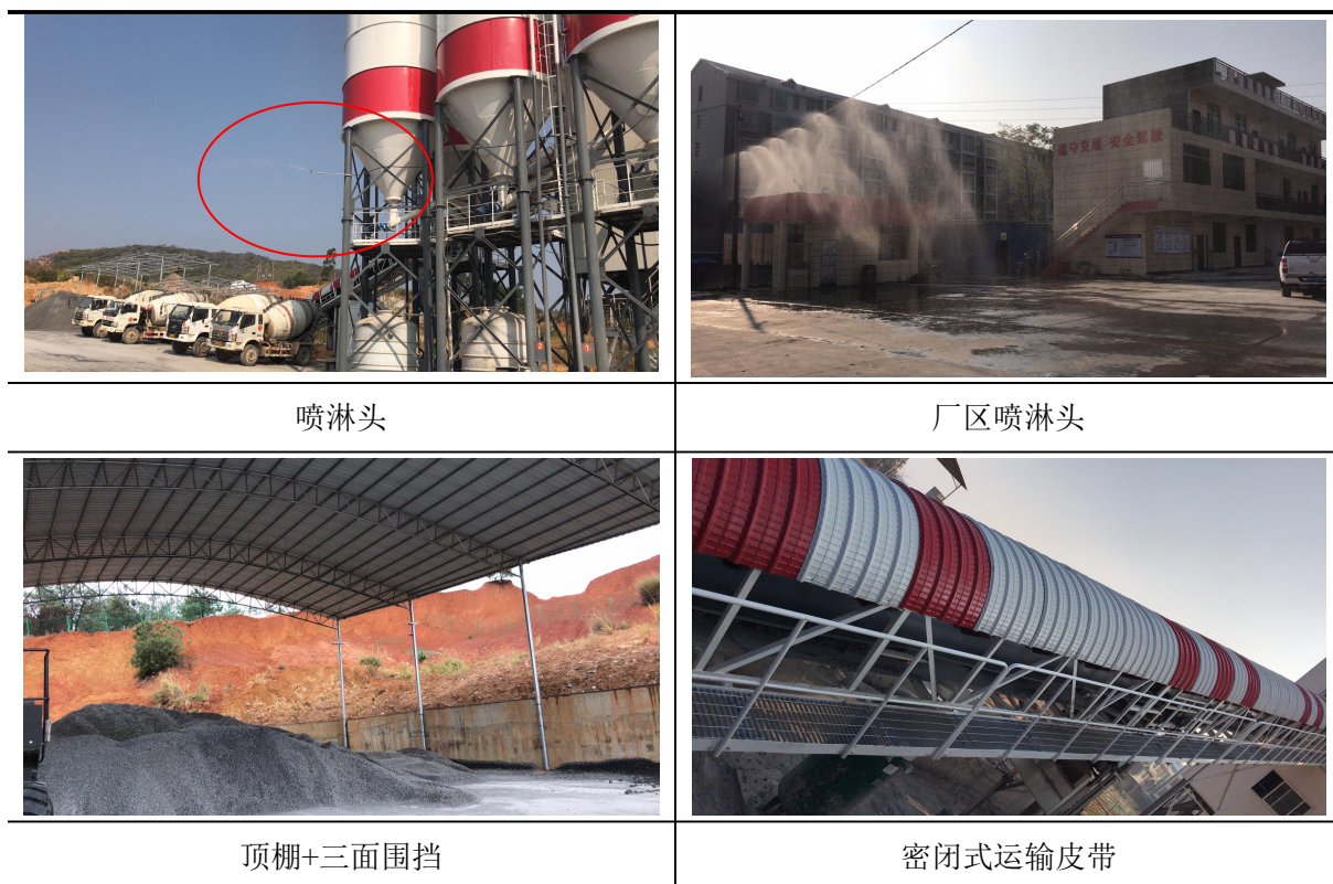
图 4-2 废气处理设施照片
